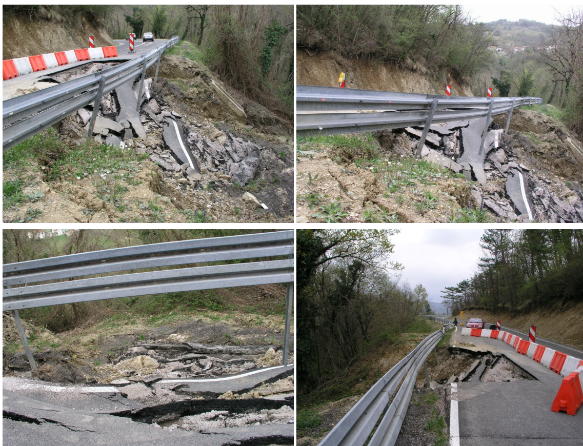
Slika 4.14 Fotografije snimljene nakon klizanja na klizištu Marinci (foto: Ž. Arbanas, 2006.)
