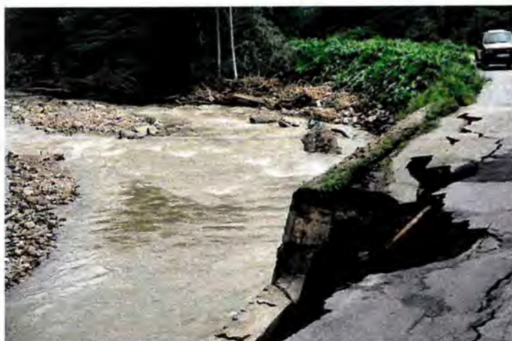
Slika 5.26. Poplavom oštećena prometnica Čabar-Zamost
