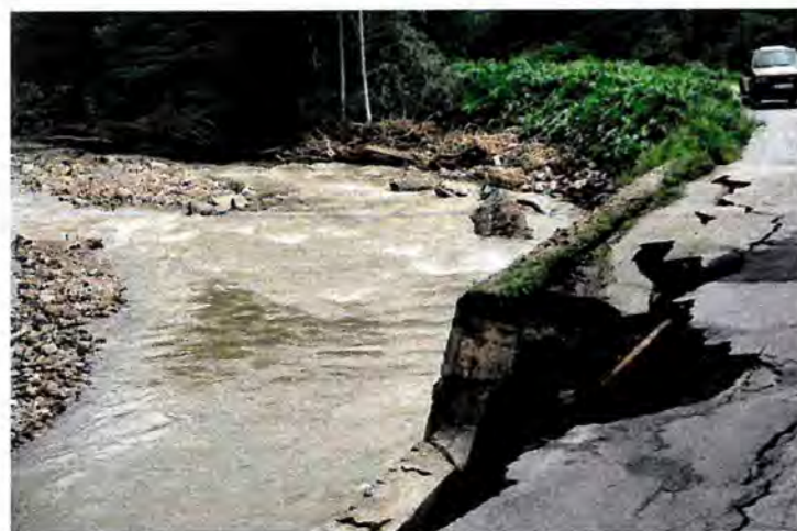
Slika 5.26. Poplavom oštećena prometnica Čabar-Zamost
