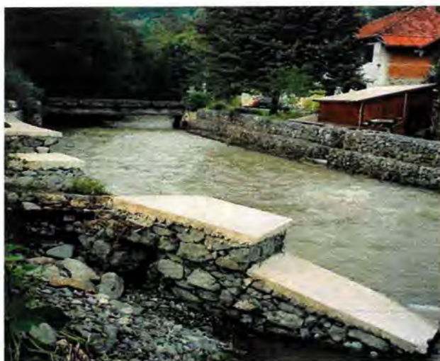
Slika 5.25. Poplavom oštećena obaloutvrda
