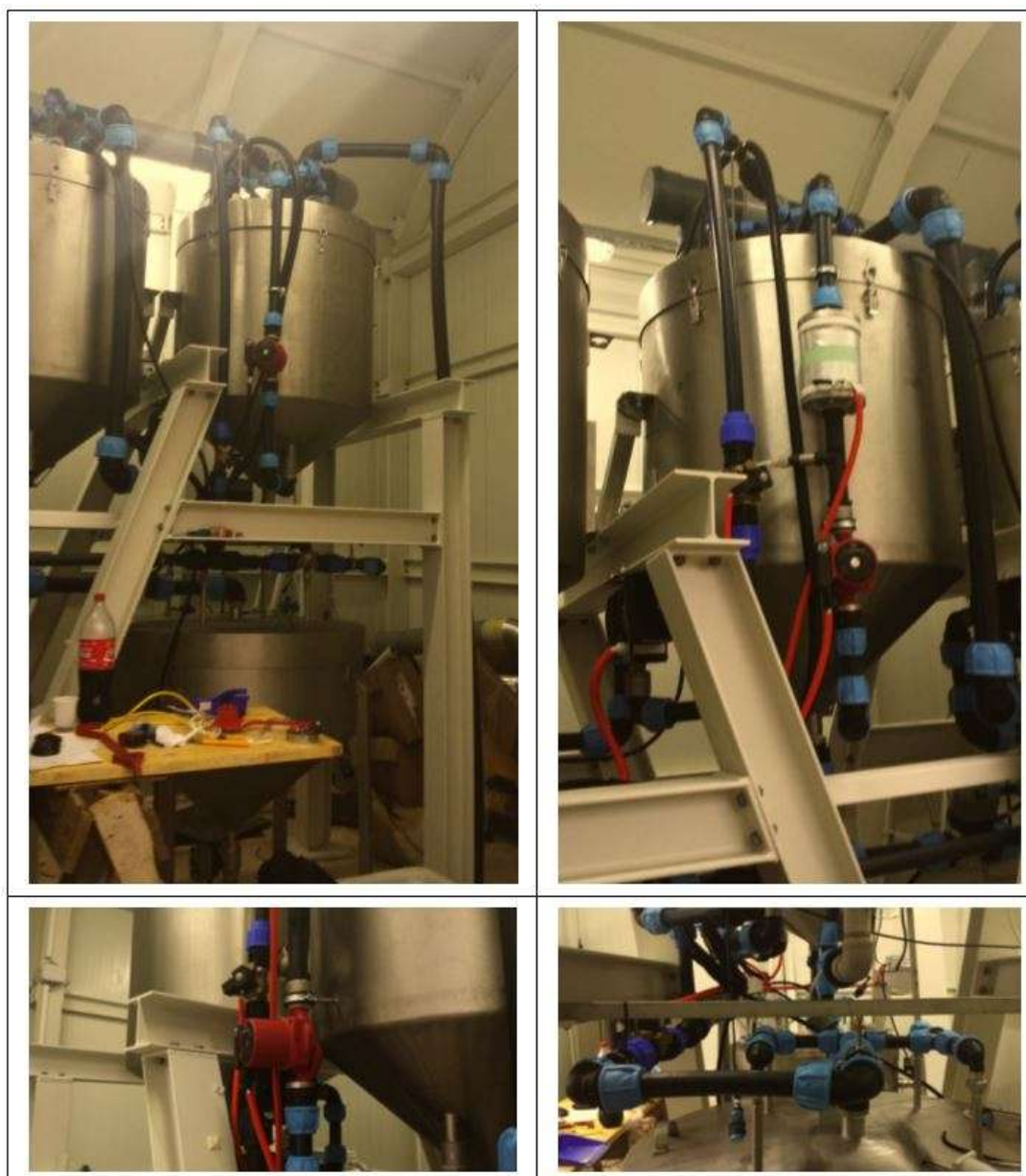
Slika 5.2 Detalji izvedbe uređaja za pročišćavanje procjednih voda.
