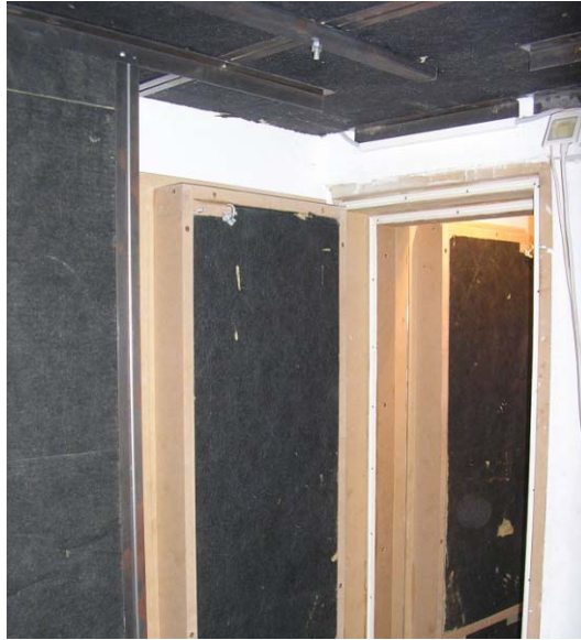
Slika 4.6. Dvostruka vrata između gluhe komore i prostora oko ječne komore
