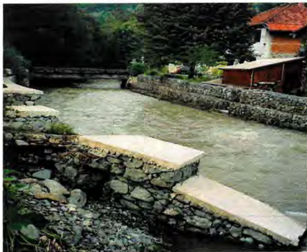
Slika 5.25. Poplavom oštećena obaloutvrda
