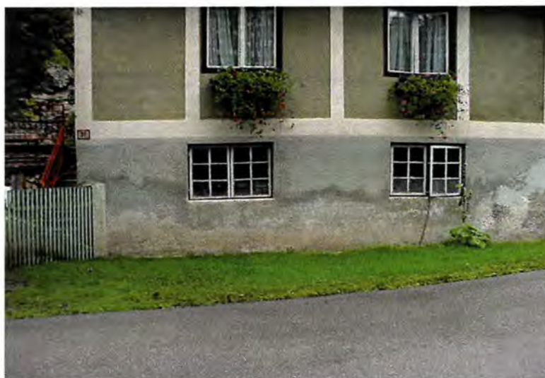
Slika 5.34. Tragovi poplave na fasadi kuće u naselju Kuželj
