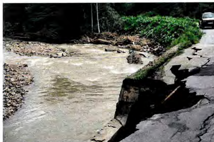
Slika 5.26. Poplavom oštećena prometnica Čabar-Zamost
