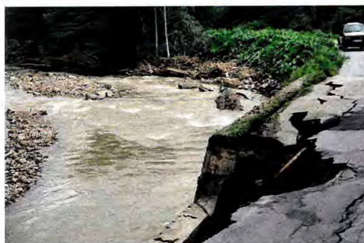
Slika 5.26. Poplavom oštećena prometnica Čabar-Zamost
