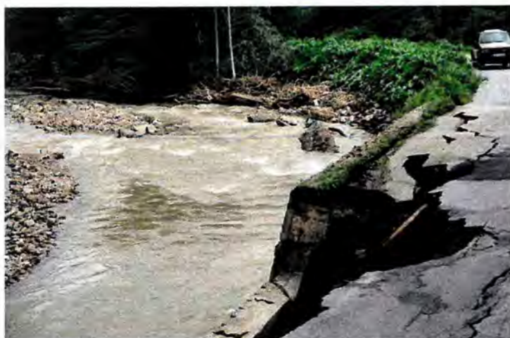
Slika 5.26. Poplavom oštećena prometnica Čabar-Zamost
