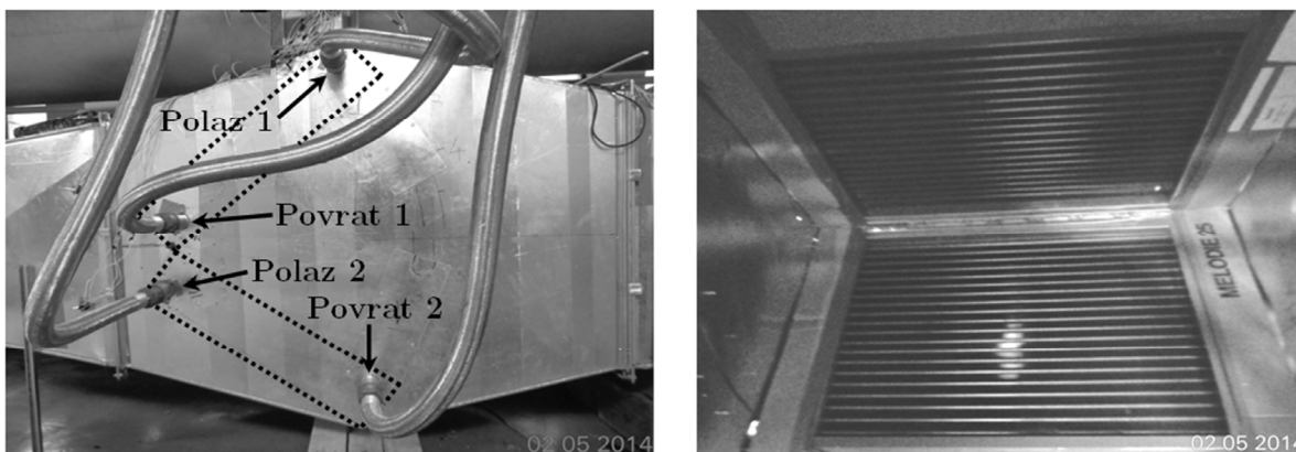
Slika 6.82. Spajanje polaznih i povratnih cijevi na izmjenjivače 3R:10×6/V (lijevo) i pogled s ulazne strane zraka u zračnom kanalu (desno)
