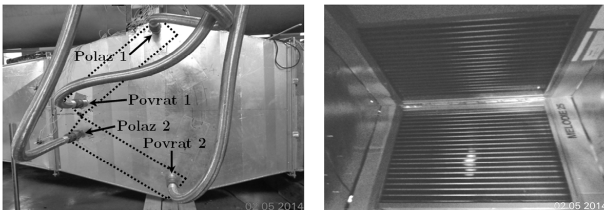
Slika 6.82. Spajanje polaznih i povratnih cijevi na izmjenjivače 3R:10×6/V (lijevo) i pogled s ulazne strane zraka u zračnom kanalu (desno)
