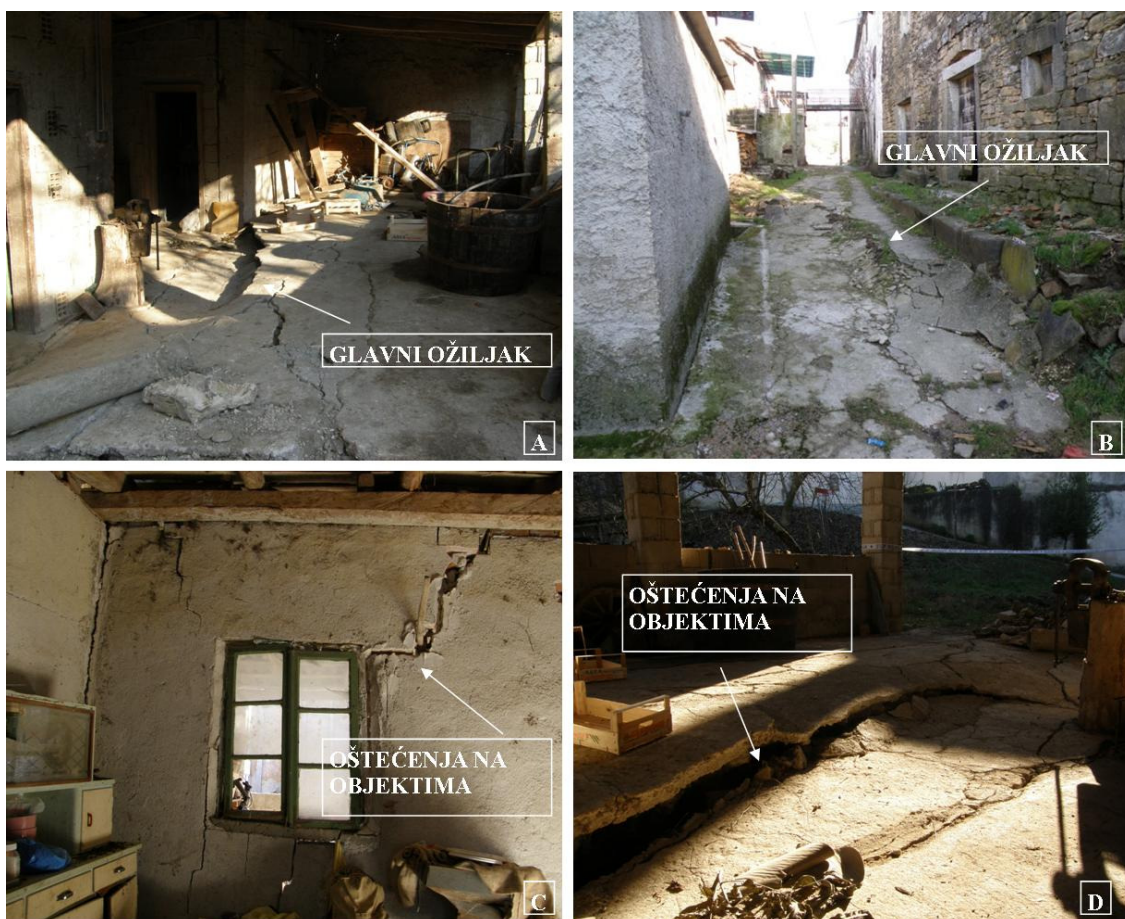
Slika 4.16 Fotografije snimljene nakon početka klizanja na klizištu Juradi: a) i b) fotografije glavnog ožiljka; c) i d) fotografije oštećenja na objektima unutar klizišta (travanj 2011.)
