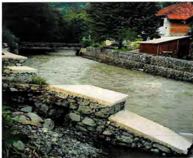
Slika 5.25. Poplavom oštećena obaloutvrda
