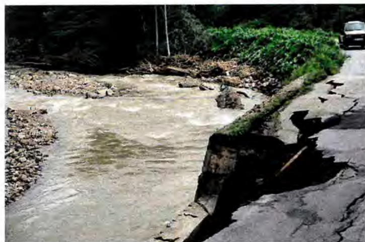
Slika 5.26. Poplavom oštećena prometnica Čabar-Zamost
