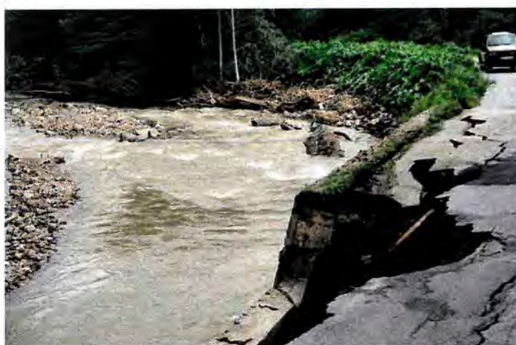
Slika 5.26. Poplavom oštećena prometnica Čabar-Zamost
